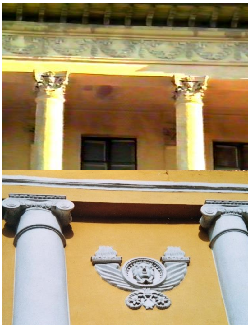
Рис.27. Архитрав, фриз с гирляндами, карниз, ул. Елькина, д. 75, г. Челябинск; архитрав, г. Оренбург
