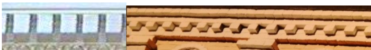
Рис.100. Капли под карнизом, г, Челябинск; Капли под карнизом, г. Оренбург
