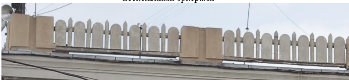
Рис.352. Ограждение над карнизом с тумбами, вместо балясин бетонные пластины выполненные под деревянный забор, башня МГТУ
