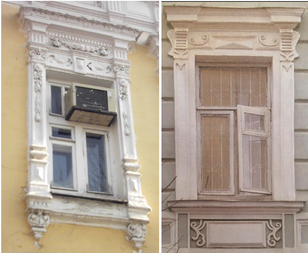
Рис.157. Узорчатое обрамление окна, купеческий стиль; стиль эклектика: квадра, завитки, сандрик с небольшими орнаментированными консолями, подоконная плита с узором и филенкой, г. Оренбург
