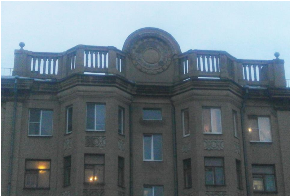
Рис.183. Круглый аттик с розеткой в плоскости, граная балюстрада примыкает непосредственно к аттику, пр. Metallургов, д.19
